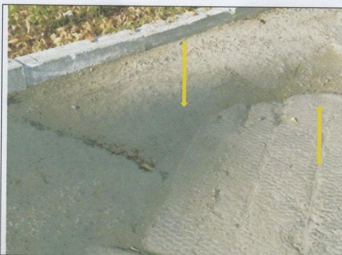
Фото №4 Путь от к объекту. Разрушение асфальтового покрытия.
