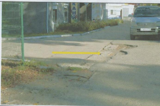
Фото №2 Путь от к объекту. Разрушение асфальтового покрытия.
