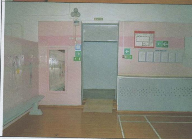
Фото №18 Дверь к эвакуационному выходу имеет порог высотой 10см.
