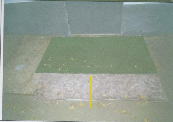
Фото №11 Вход в здание. Противоскользящее покрытие отсутствует.
