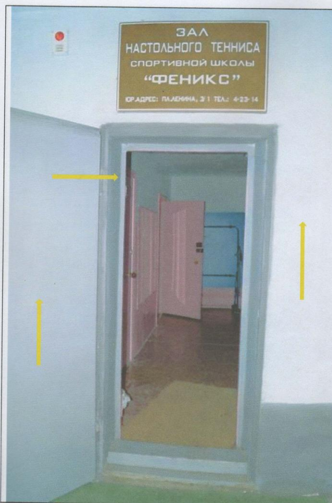
Фото №12 Вход в здание. Высота порога 20см. Отсутствуют поручни и пандус. Вход не выделен цветом, знаки доступности не установлены. Отсутствует кнопка вызова персонала.
