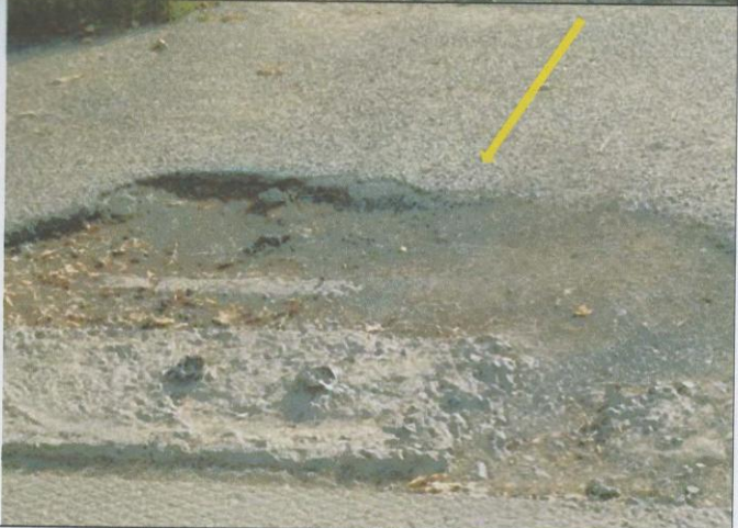
Фото №6 Путь от к объекту. Разрушение асфальтового покрытия.
