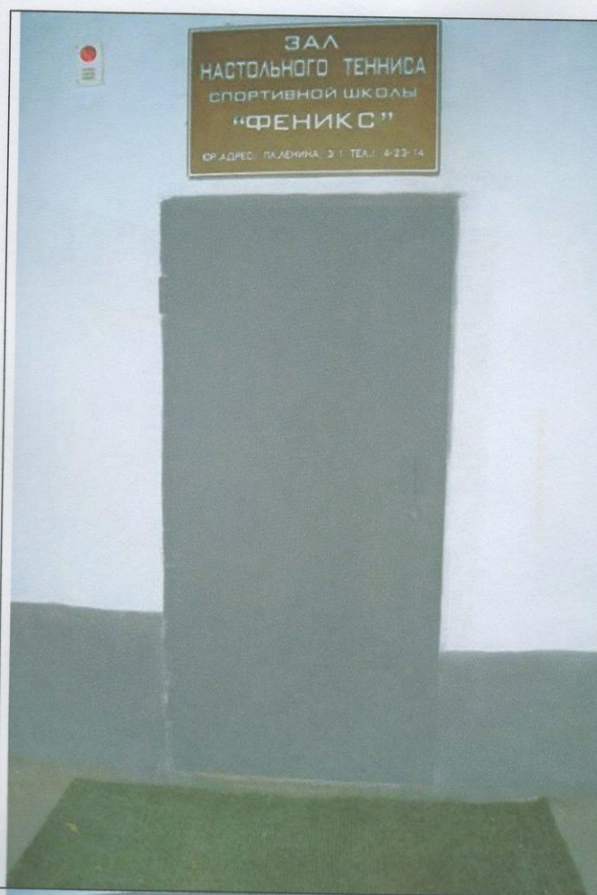
Фото №10 Вход в здание. Входная площадка отсутствует
