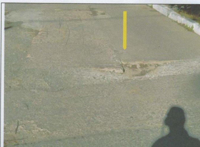
Фото №7 Путь от к объекту. Разрушение асфальтового покрытия.
