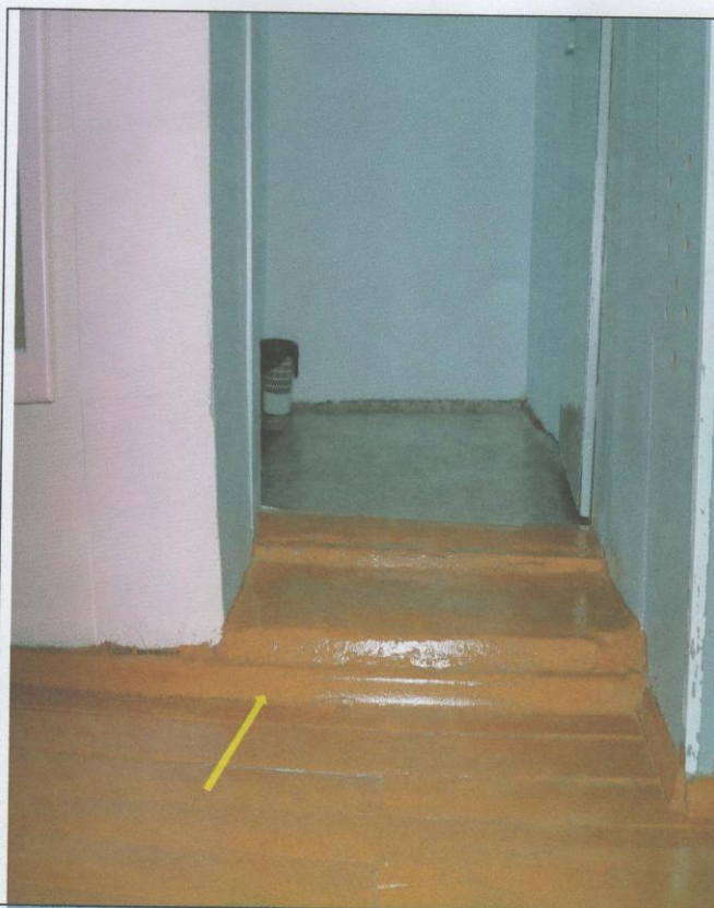
Фото №19 Дверь к эвакуационному выходу имеет порог высотой 10см.
