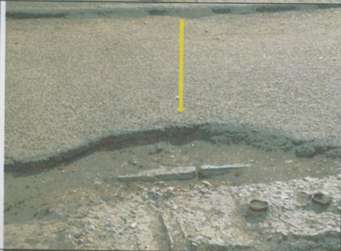
Фото №5 Путь от к объекту. Разрушение асфальтового покрытия.
