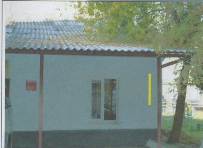
Фото №9 Вход в здание. Водоотвод отсутствует.
