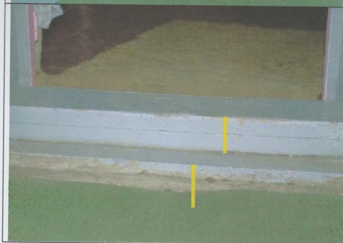
Фото №13 Вход в здание. Высота порога 20см.
