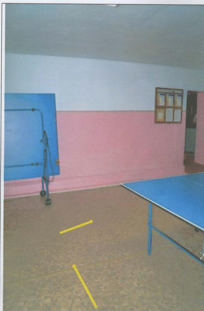
Фото №15 Пути движения внутри здания. Отсутствует нескользящее покрытие. Не выделена зона отдыха и ожидания.
