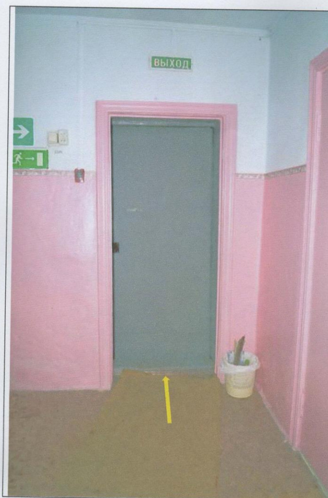
Фото №14 Пути движения внутри здания. Отсутствует информация о схеме движения инвалидов по зданию, маршрут движения не обозначен знаками.
