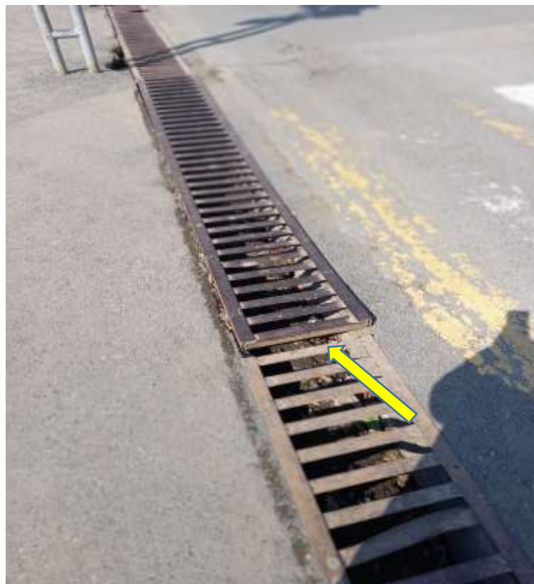
Фото №2 Путь к объекту. Деформация ливневой решетки.
