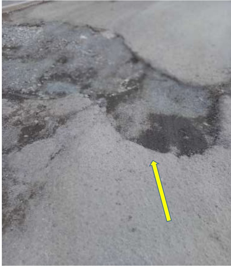
Фото №7 Путь к объекту. Разрушение асфальтового покрытия.
