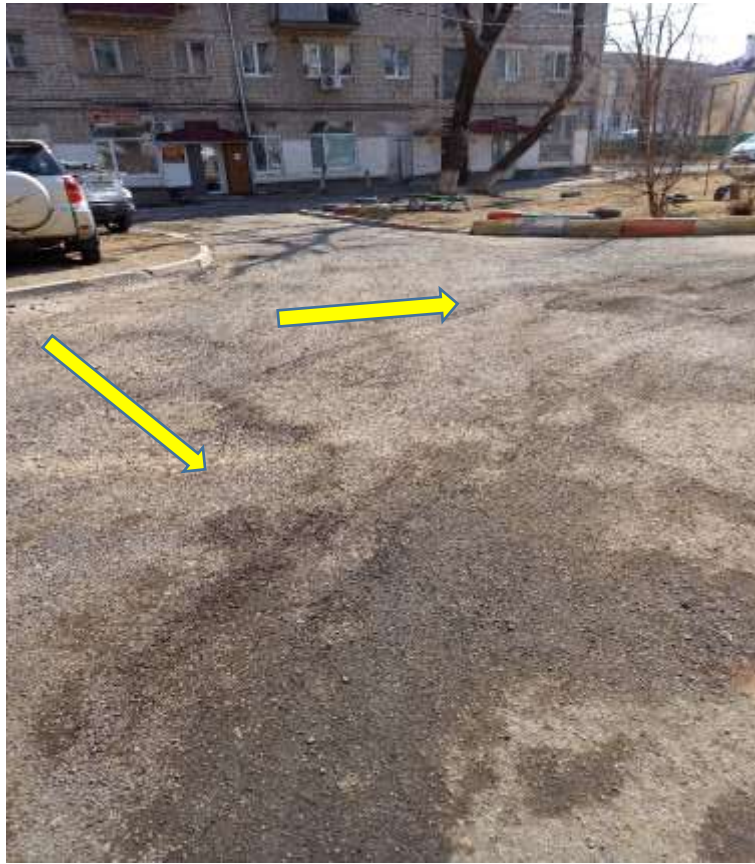
Фото №19 Путь к объекту. Разрушение асфальтового покрытия.
