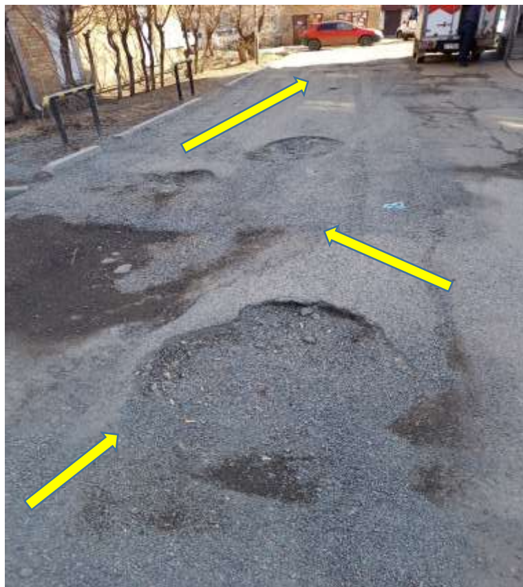
Фото №18 Путь к объекту. Разрушение асфальтового покрытия.
