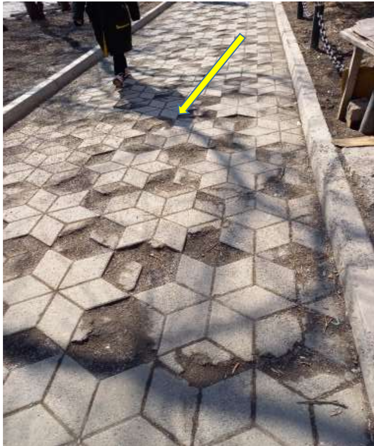
Фото №16 Путь к объекту. Разрушение брусчатки.
