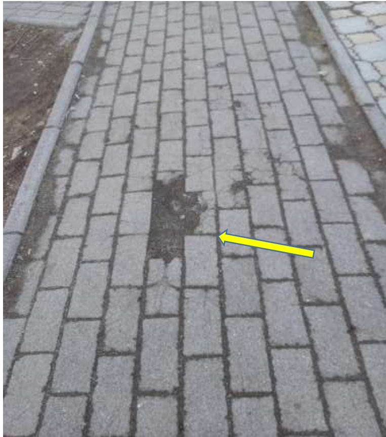
Фото №5 Путь к объекту. Разрушение брусчатки.
