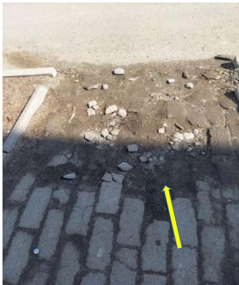
Фото №6 Путь к объекту. Разрушение брусчатки.
