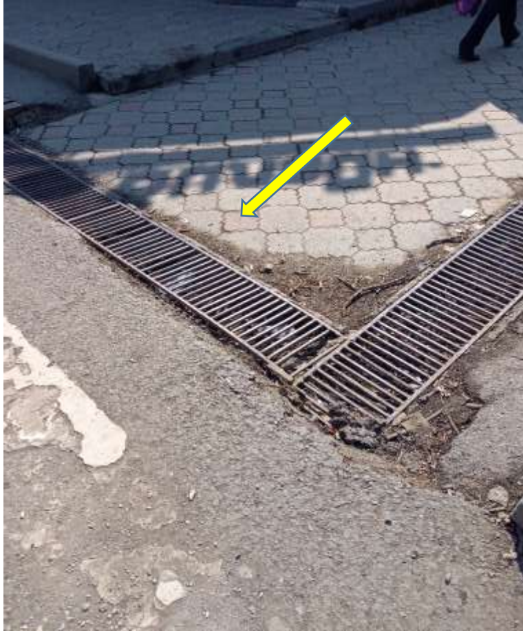
Фото №13 Путь к объекту. Деформация ливневой решетки.
