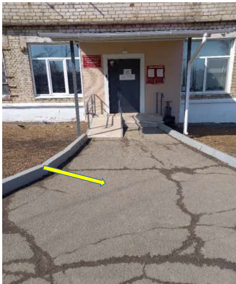
Фото №21 Вход в здание. Разрушение асфальтового покрытия.
