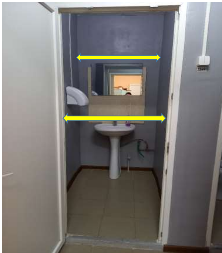
Фото №50 Санитарно-гигиенические помещения. Ширина двери умывальника 70см, открывается наружу. Ширина комнаты 110см. Отсутствует опорная стойка, крючки для вещей. Отсутствуют откидные опорные поручни, штанги, поворотные или откидные сидения. Специальные знаки отсутствуют, в т.ч. и рельефные.
