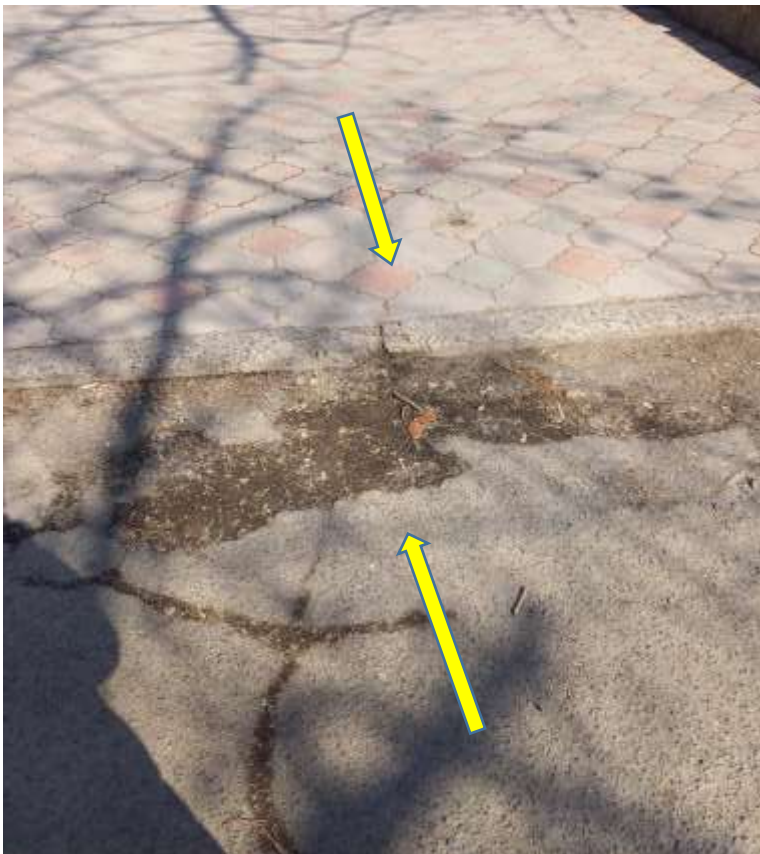
Фото №14 Путь к объекту. Бордюр 5см. Разрушение асфальтового покрытия.
