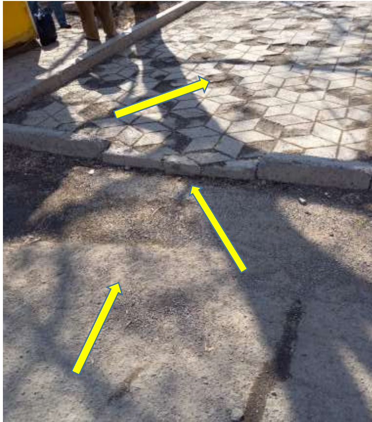
Фото №15 Путь к объекту. Бордюр 7 см. Разрушение брусчатки и асфальтового покрытия.
