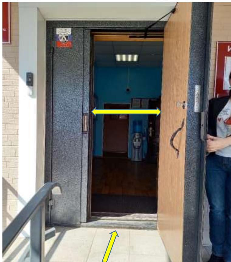
Фото №23 Вход в здание Высота порога 7см. Вход не выделен цветом, знаки доступности не установлены. Ширина двери 70см
