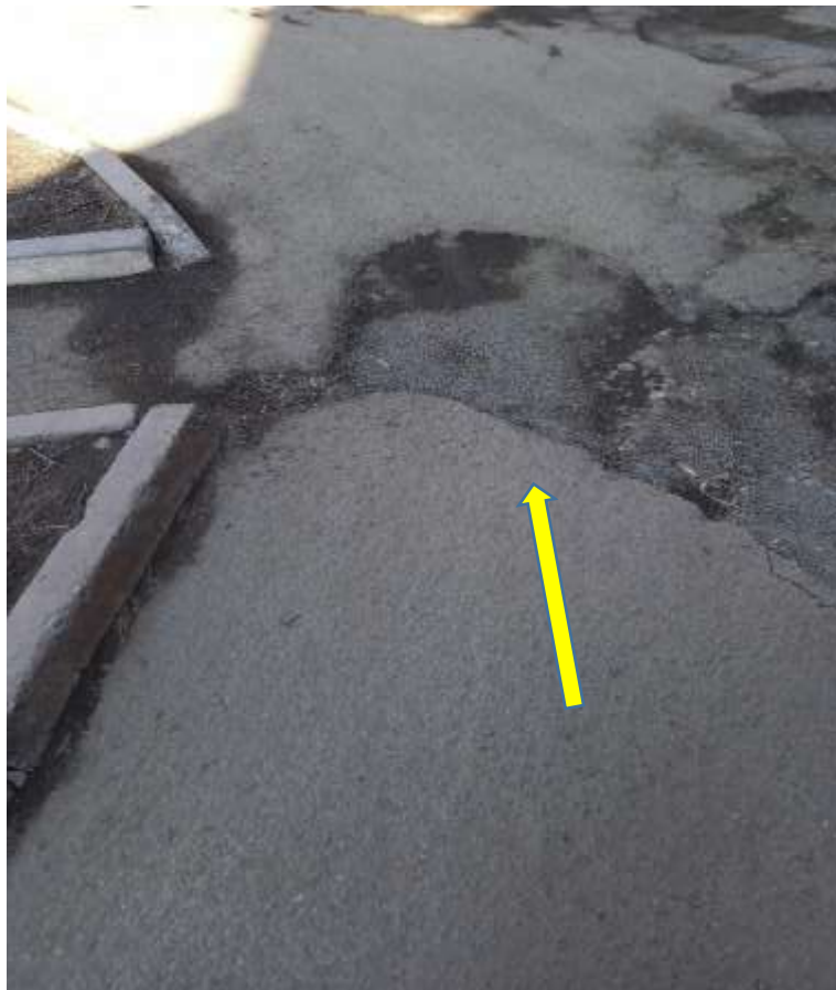
Фото №8 Путь к объекту. Разрушение асфальтового покрытия.
