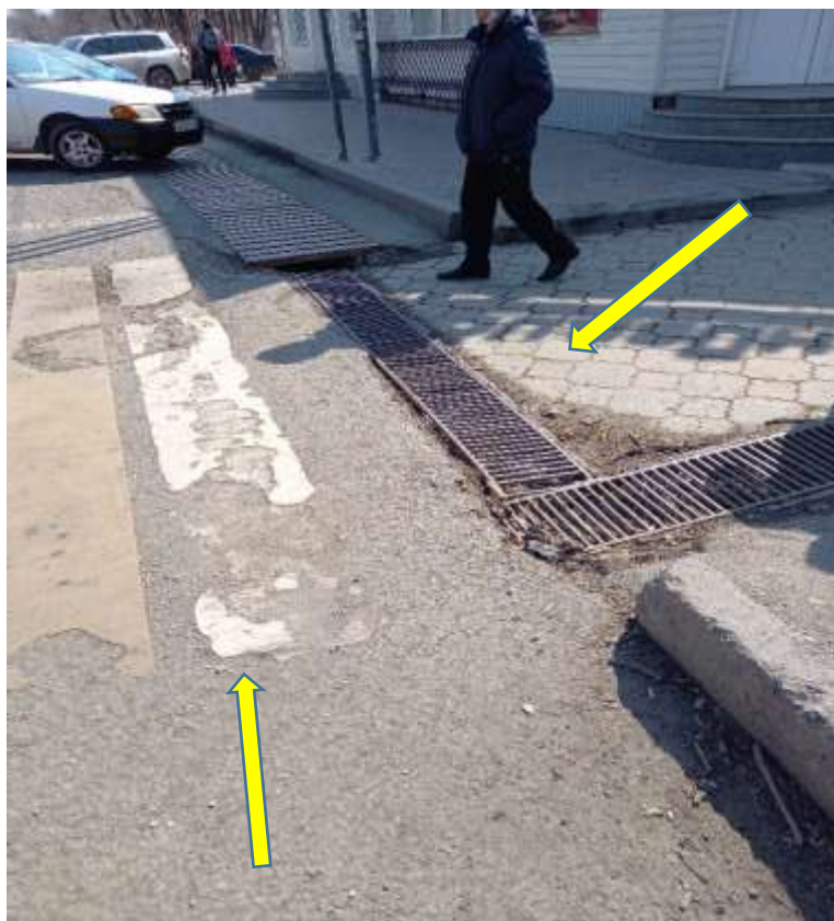
Фото №12 Путь к объекту. Разрушение асфальтового покрытия и брусчатки.
